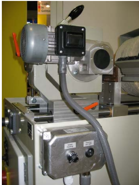
Vorschubaggregat mit Frequenzumformer
